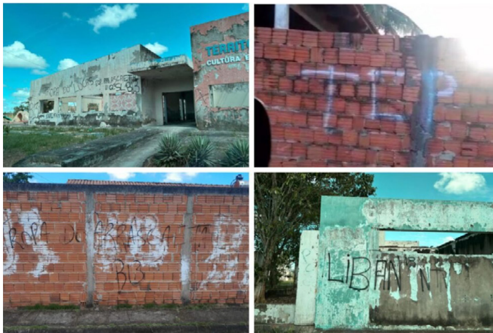
Figura 3.3 | Pichações da união das facções B13 e TCP, no Conjunto habitacional Cidade do Povo Rio Branco - AC
